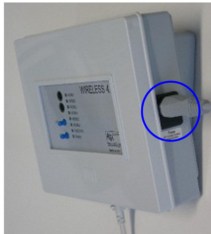
Position der Netzbuchse an der Mainstation W4.2
